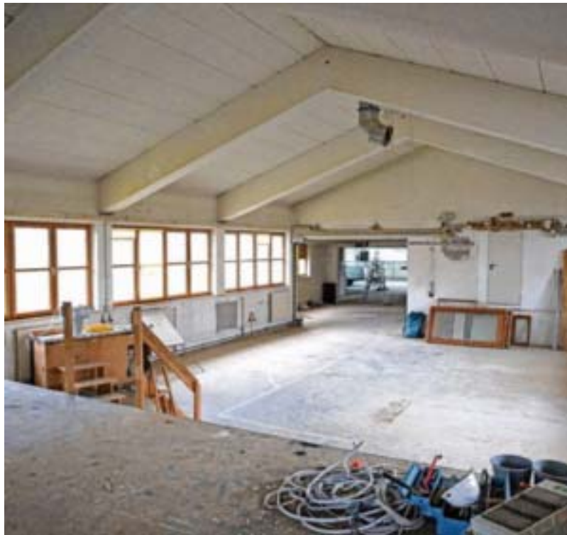
So sieht es derzeit noch im Herz-Gebäude aus. Künftig soll das Gebäude die Jugend- und Kulturwerkstatt Durachs sein. Foto: Matthias Becker
